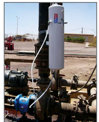
在智利的SQM采矿工厂，70多个AESSEAL®的泥浆密封与SSE-25™辅助系统安装使用，上图是其中一个辅助系统。
