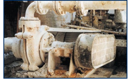
AESSEAL® installierte Dichtung an einer Stoffauflaufpumpe
