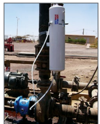
Eine von über 70 AESSEAL® Schlamm dichtungen und SSE-25™-Systemen, die bei SQM Mining, Chile, eingebaut wurden
