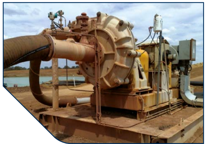
Nach Installation des AESSEAL® Doppeldichtungs- und Tanksystems
