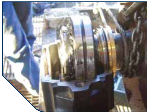
Łożysko ślizgowe dzielone z uszczelnieniem LabTecta®66PB zainstalowane w papierni (Nr przypadku 3217)
