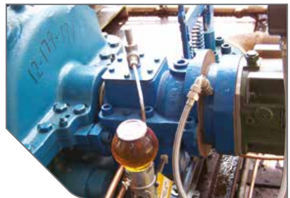
Uszczelnienie LabTecta®66 zainstalowane w turbinie parowej w rafinerii w USA (Nr Przypadku: 3495)
